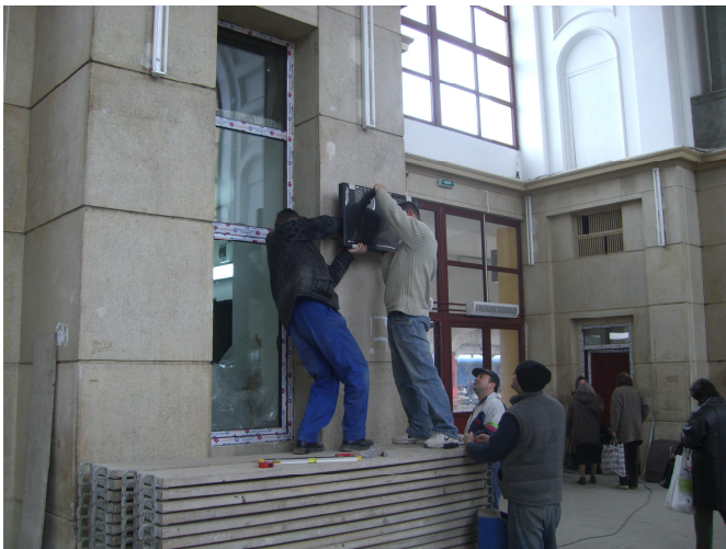
Instalare panou afisare mersul trenurilor informatii
